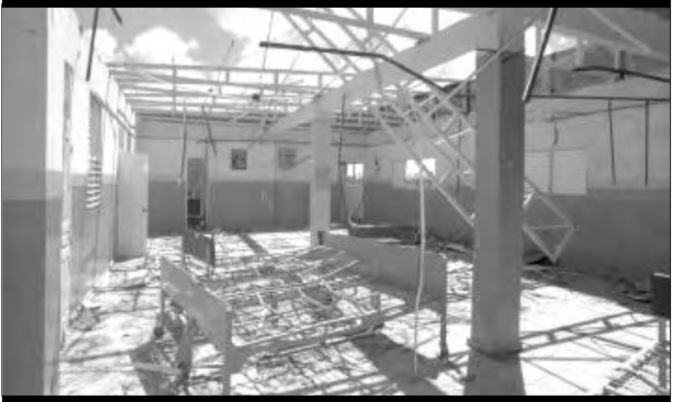
Daños en el interior del hospital Dr. Carl T. George.
