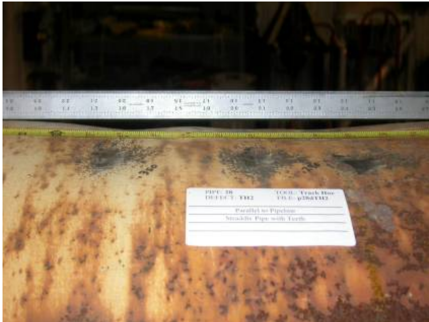
Figure 3-21. Defects D13, D14, D15 (p28dTH2)
