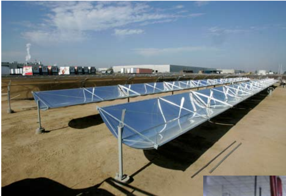
Grâce à ces panneaux solaires, l'usine Frito-Lay implantée à Modesto, en Californie, captera suffisamment d'énergie pour produire environ 145 000 sachets de SunChips par jour.
