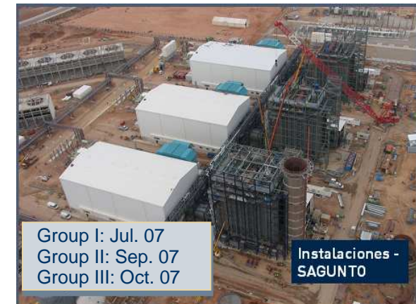
CCGT SAGUNTO 1.200 MW
