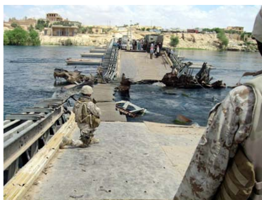
Collaboration entre les Marines et les autorités locales pour la reconstruction d'un pont à Haddita
