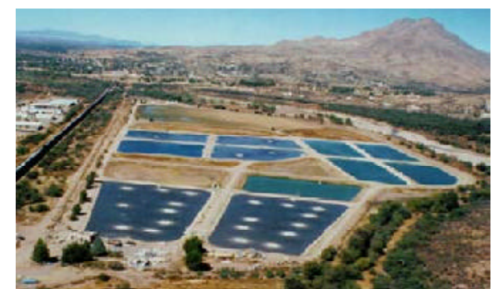
Nogales International Wastewater Treatment Plant / Planta Internacional de Tratamiento de Aguas Residuales
