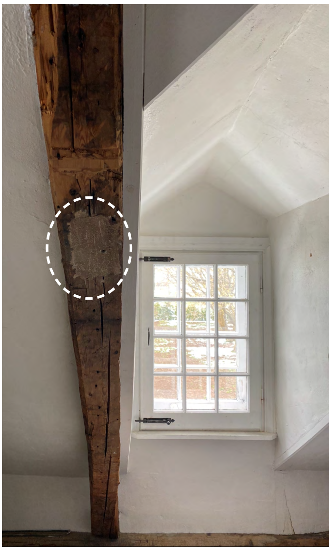
3. Emplacement des anciennes mortaises au niveau d'un chevron.
