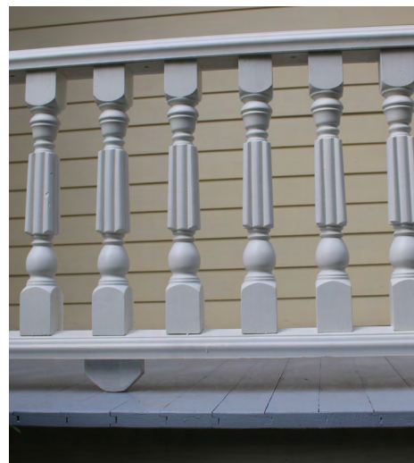
6. Vue d'une section de la balustrade avec sa cale de support sous la lisse et située à mi-portée.
