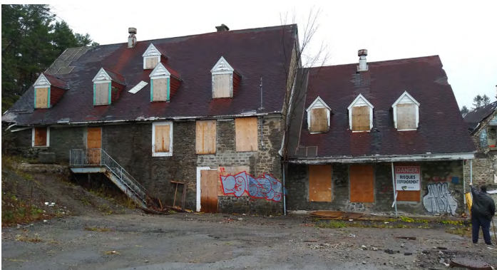
État actuel du moulin et de la maison du meunier de Mascouche. Source : SODAM/Société d'histoire de Mascouche, 2018.
