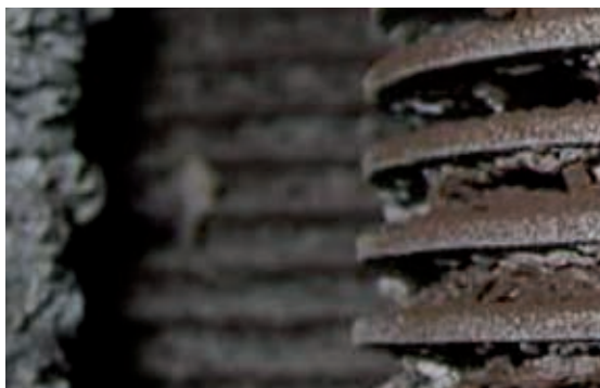
Verunreinigte, mit herkömmlichen Reinigungsmethoden schwer zu reinigende Anlagenteile
