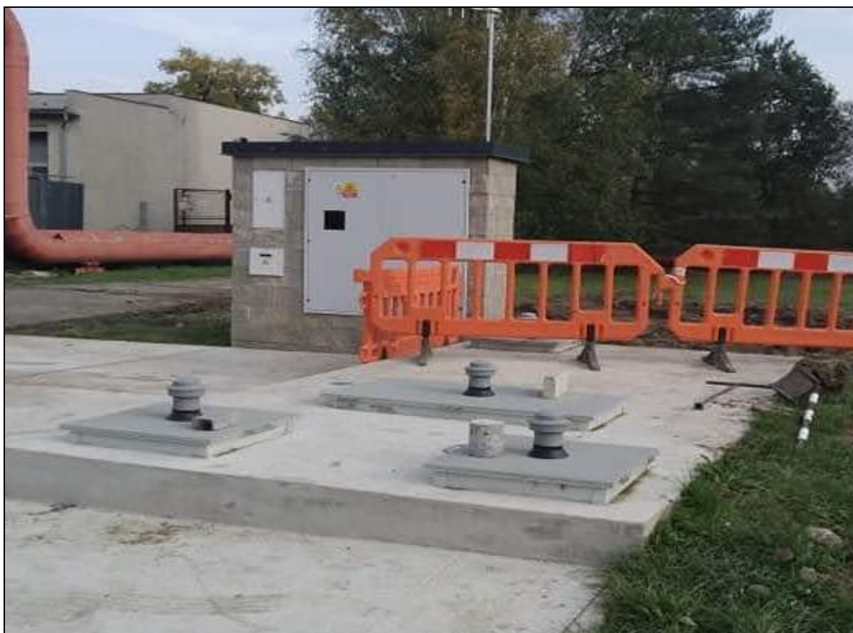
Obrázek č. 1-1: Čerpací stanice odpadních vod PZ I
