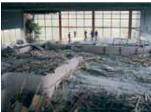
1985 brach die Betonhängendecke eines Hallenbades im schweizerischen Uster. Die Aufhängungen der Decke aus nichtrostendem Stahl zeigten rein äußerlich keinerlei Mängel, waren jedoch innerlich teilweise vollkommen durch Spannungsrisskorrosion zerstört.
